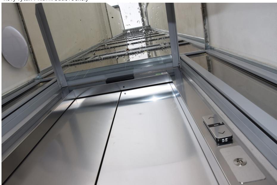
nový výtah v hlavní budově školy
